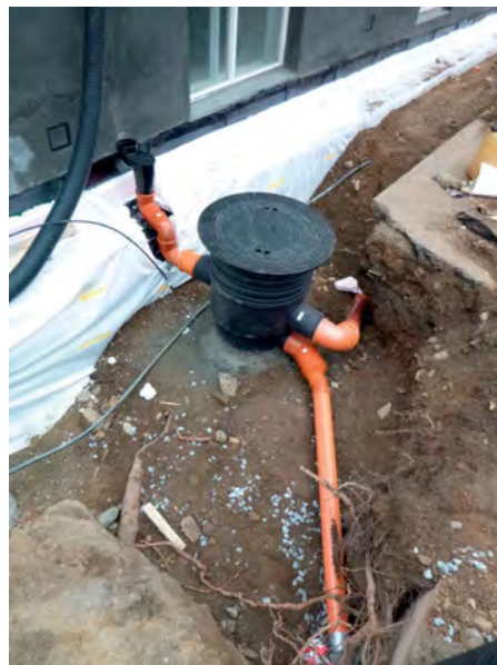
Obrázek 11-6 • Instalace filtrační šachty pro zachytávání srážkové vody napojené na dešťový svod. Spodní výtok je napojen na zasaňovací systém ke kořenům. Vrchní výtok (tzv. přepad) je napojen do dešťové kanalizace (foto archiv Arbonet).
